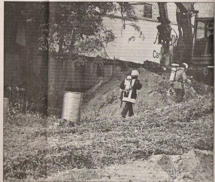
Ein Bagger war bei Erdarbeiten auf zwei Giftfässer gestoßen, die mit einer gesundheitsschädlichen Flüssigkeit gefüllt waren.
